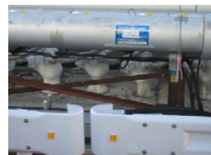
陸側凍土遮水壁設備
